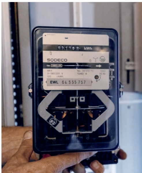
Die alten Stromzähler dürfen in den Ruhestand.
