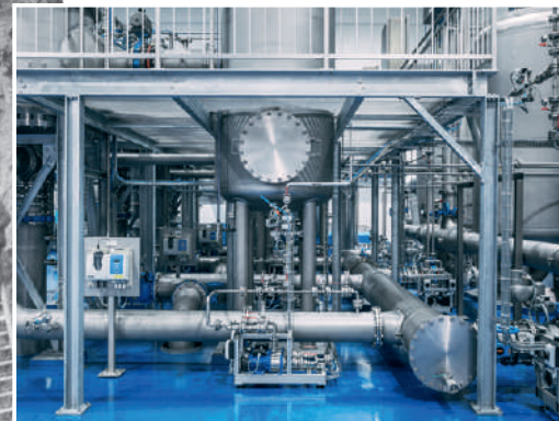
Modernste Zentrale für die Wasserversorgung heute.
