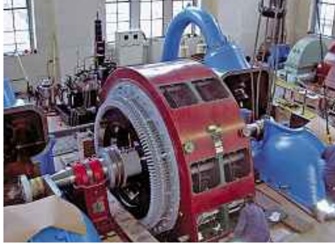
Eine offene Maschinengruppe im Kraftwerk Obermatt während der Revision.
