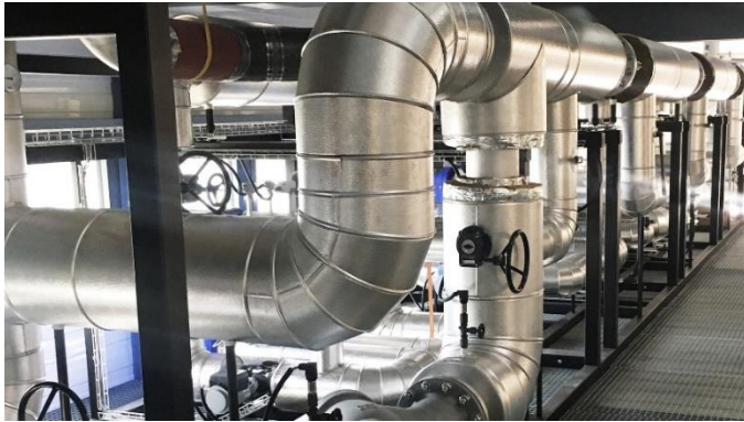
Knotenpunkt für die Fernwärmeverteilung: Wärmezentrale Emmen Luzern
